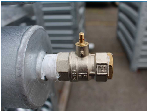
Oberer Rohrbündelanschluss mit Überdruckventil auf Verdunstungsverflüssigern.
